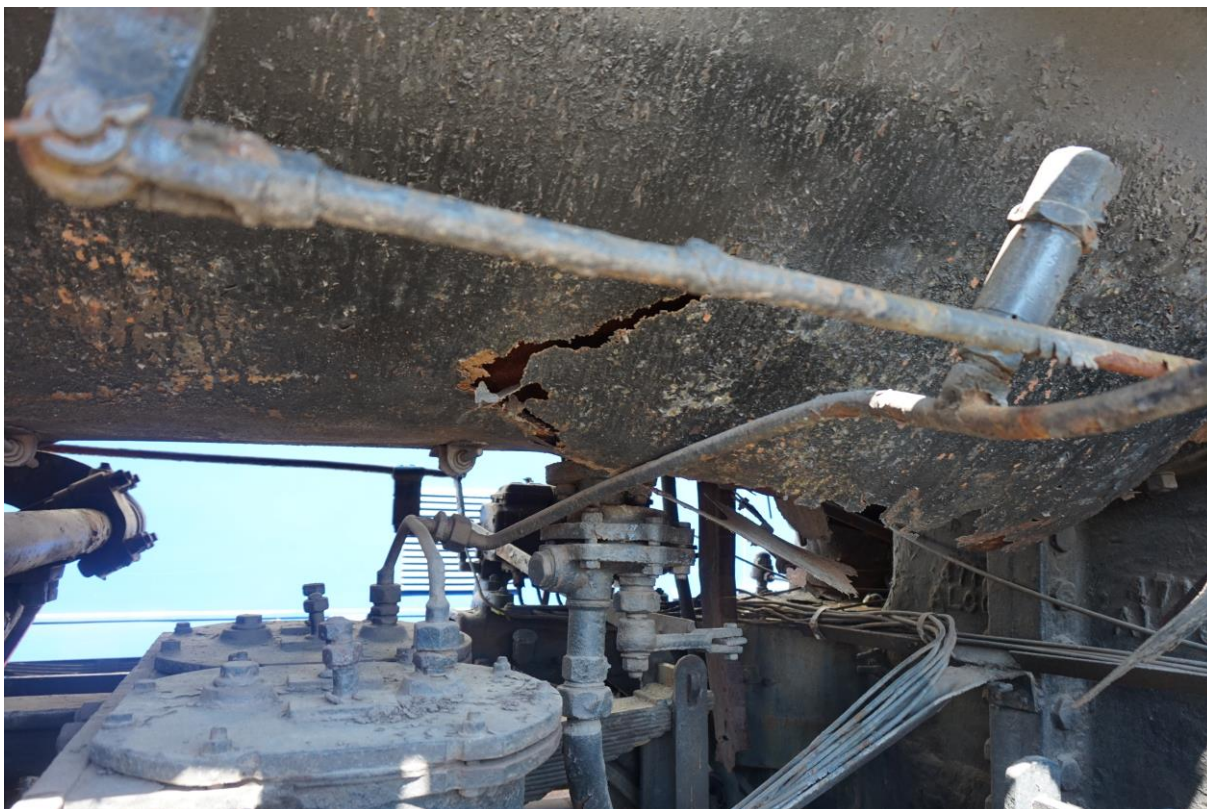
Fot. 27: uszkodzenia otuliny kotła od spodu.
