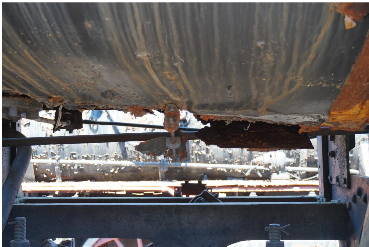
Fot. 14: uszkodzenia otuliny kotła od spodu.
