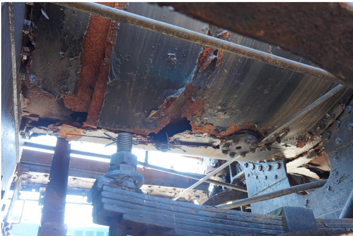
Fot. 17: uszkodzenia otuliny kotła od spodu.
