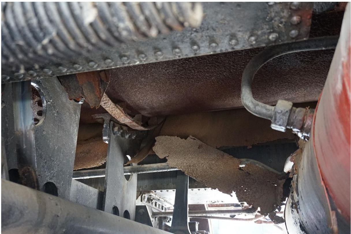
Fot. 6: uszkodzenia otuliny kotła od spodu.
