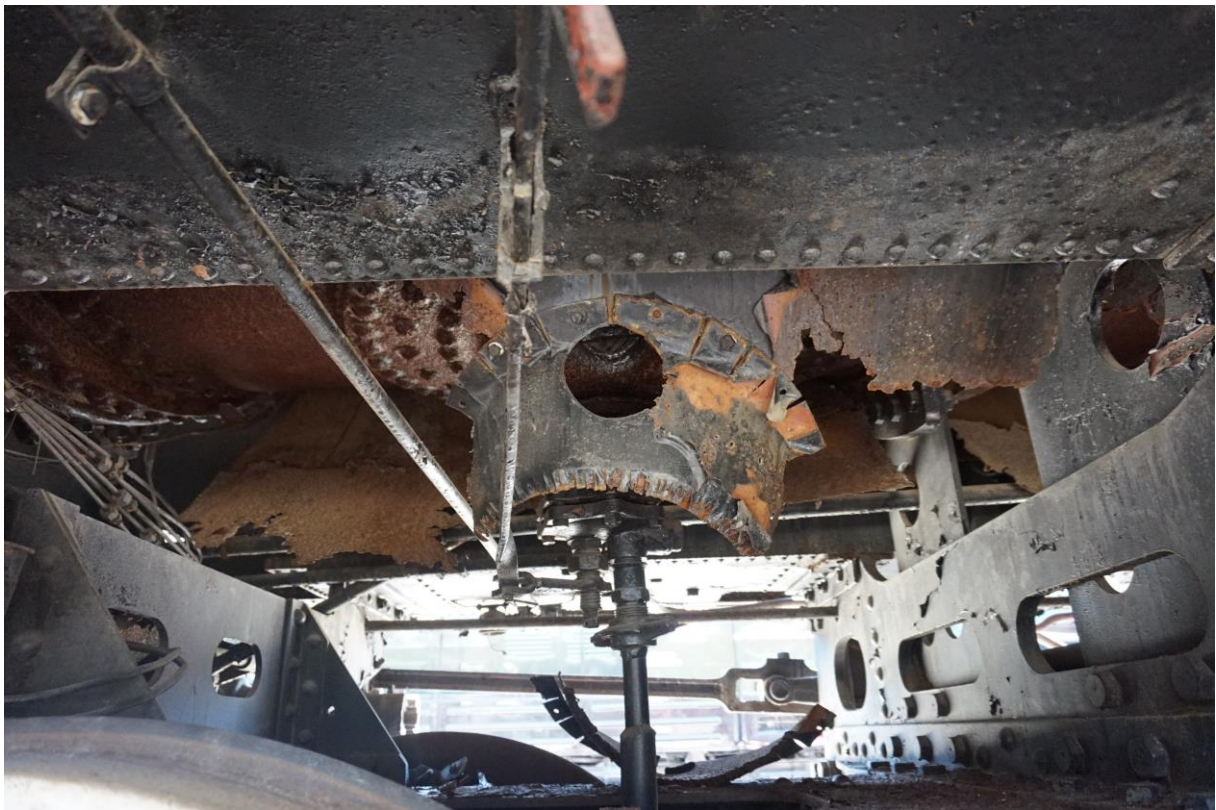
Fot. 5: uszkodzenia otuliny kotła od spodu.
