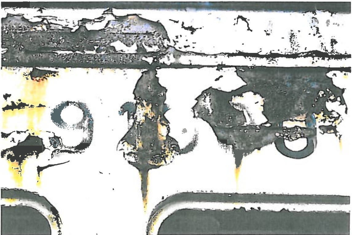
Rysunek 32: Szczegółowe zdjęcie zachowania powłoki malarskiej w miejscu naniesienia numeru pojazdu. Fot. P. Ratajczyk
