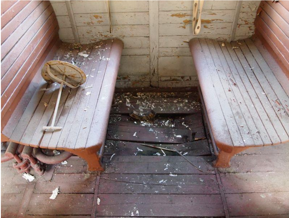
Fot. 55: Uszkodzona podłoga wewnątrz wagonu.
