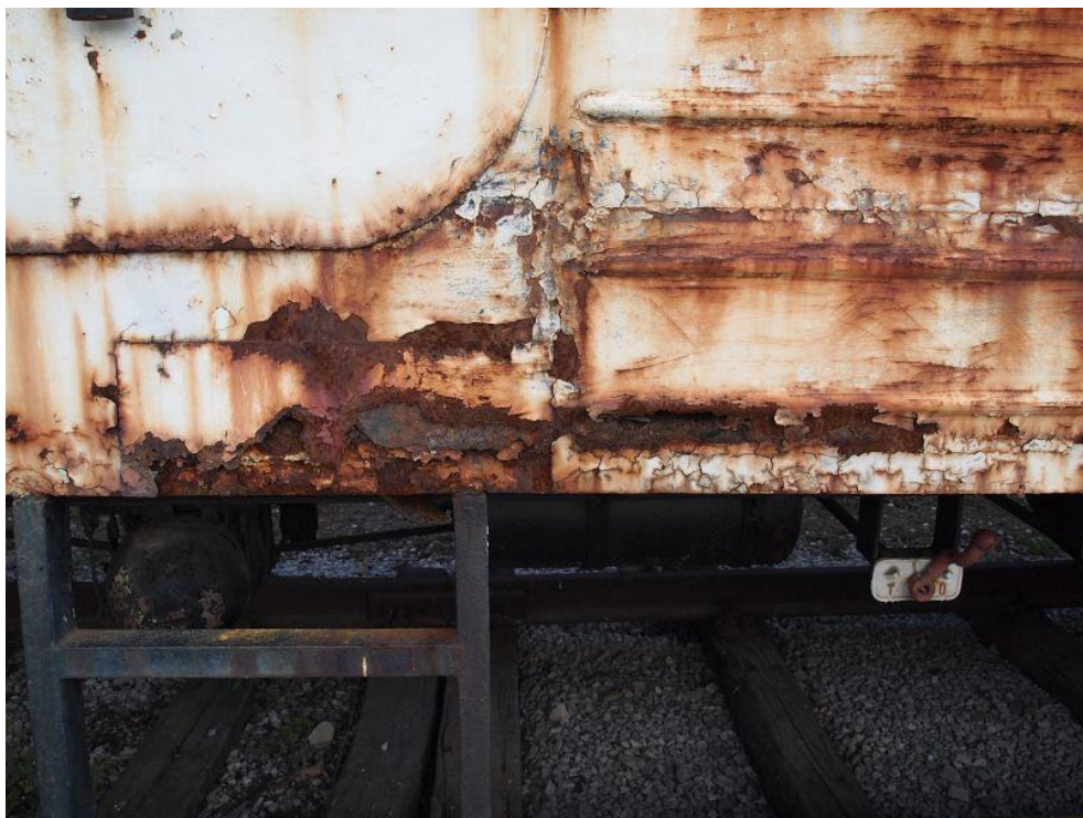
Fot. 48: Korozja i perforacja pudła wagonu na styku z ostojnicą.
