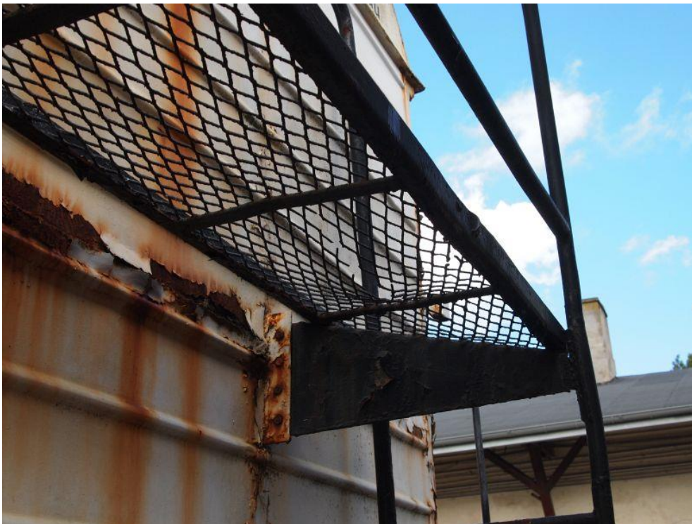
Fot. 51: Uszkodzony pomost z metalowej siatki.
