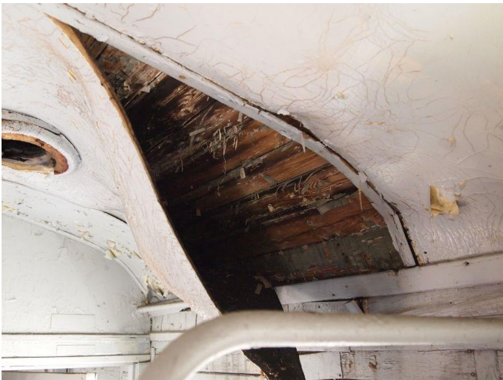
Fot. 56: Uszkodzenie wewnętrznej okładziny dachu.
