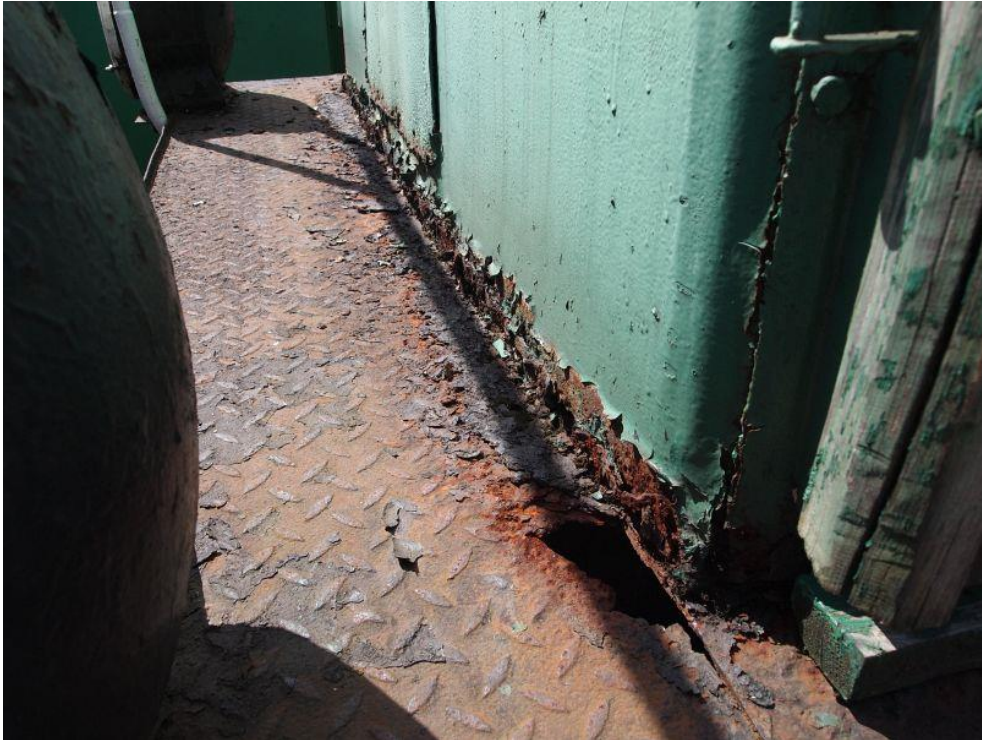
Fot. 18: korozja i perforacja na styku pudła lokomotywy i pomostu.
