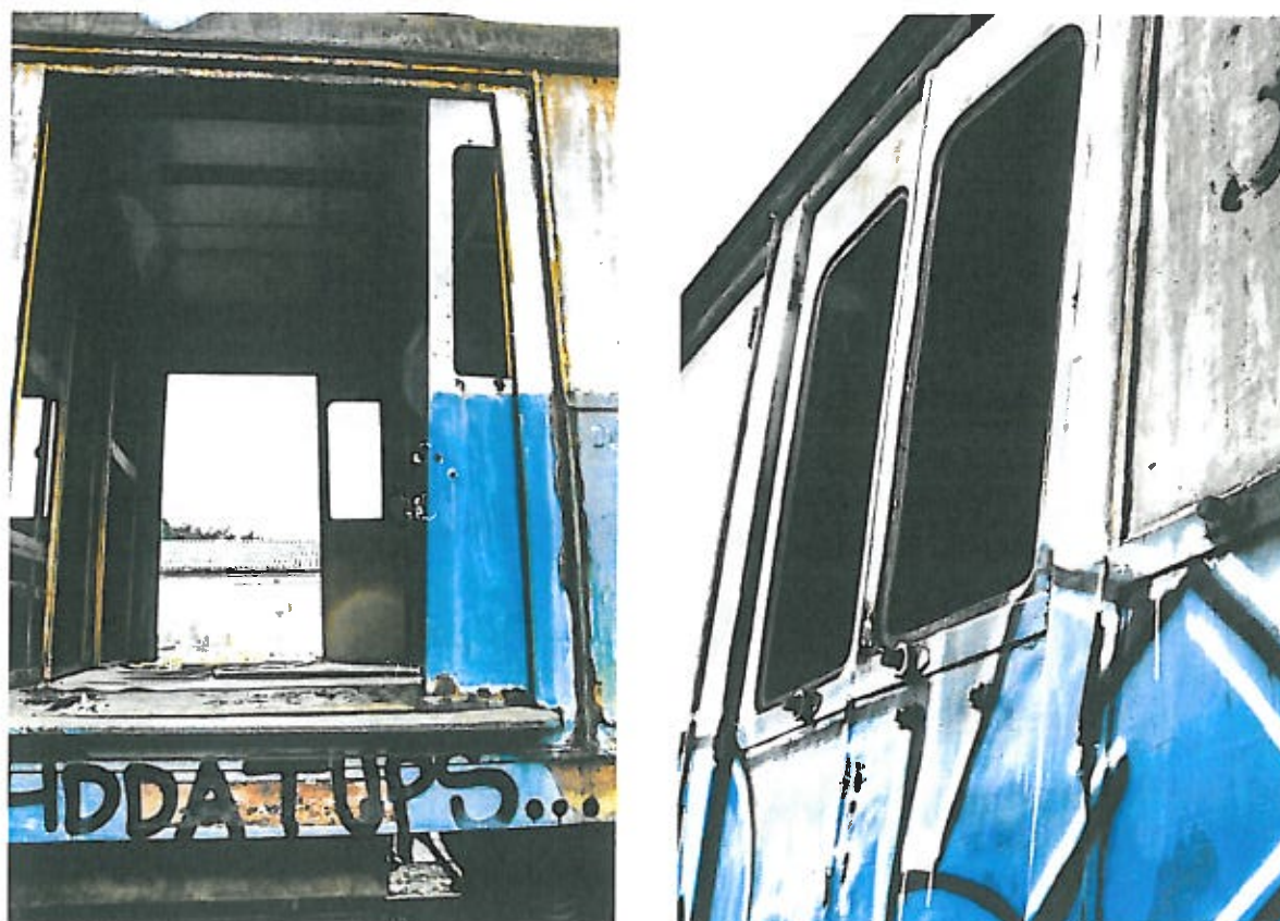
Rysunek 22: Zachowane skrzydła drzwi automatycznych (po lewej), oraz drzwi do przedziału konduktorskiego z dobrze widocznymi otworami na klamkę (po prawej). Fot. P. Ratajczyk
